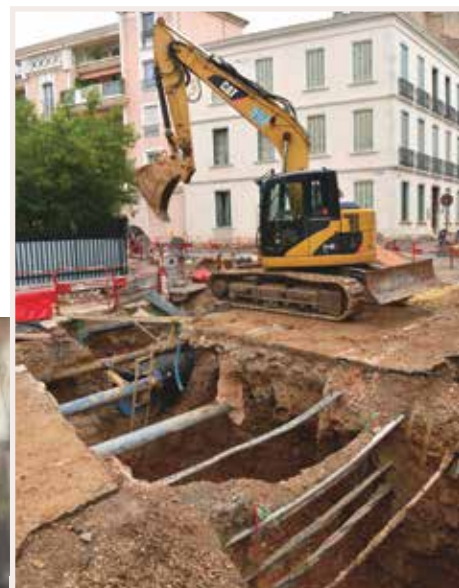
Le bassin de rétention est désormais opérationnel. Il permettra de prévenir les inondations observées sur l'avenue Alphonse Denis.
