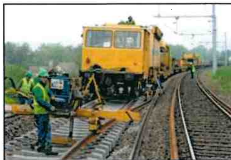
Longs Rails soudés sur traverses béton
